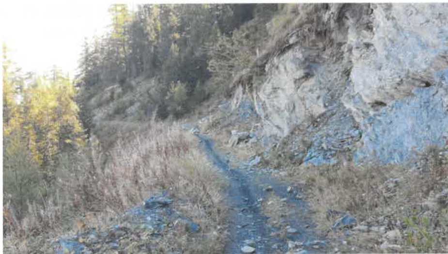
Pista forestale di accesso (sito A) da ripristinare
